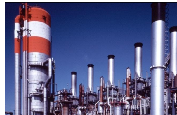
エチレン製造設備
